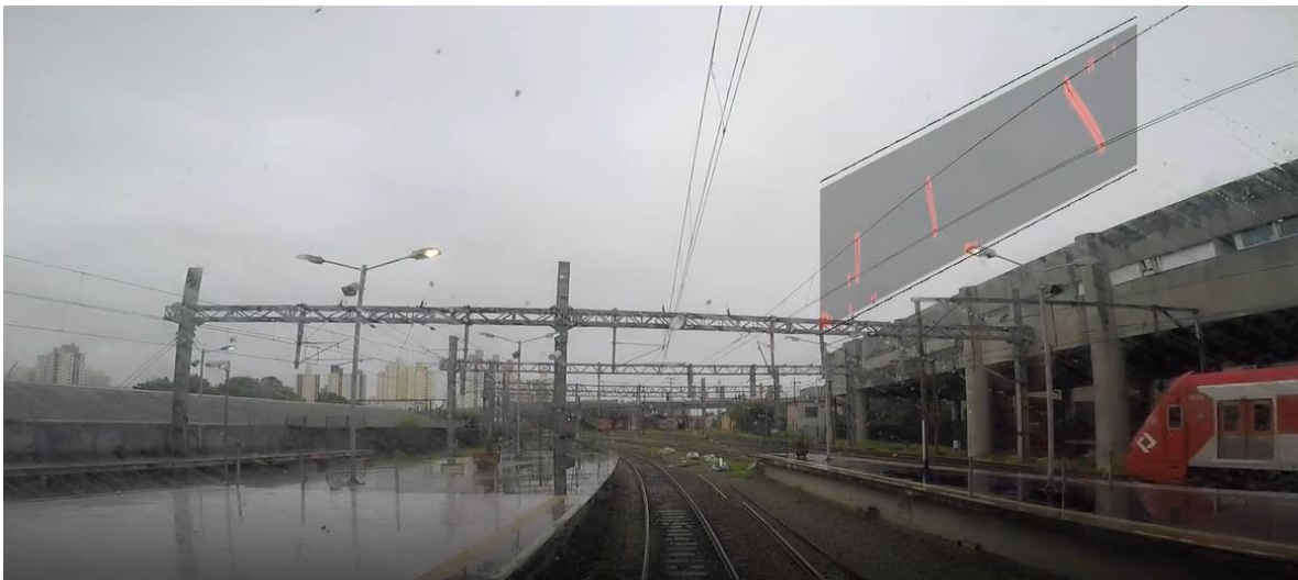
Figura 8 Monitoramento de suspensórios da Rede Aérea
