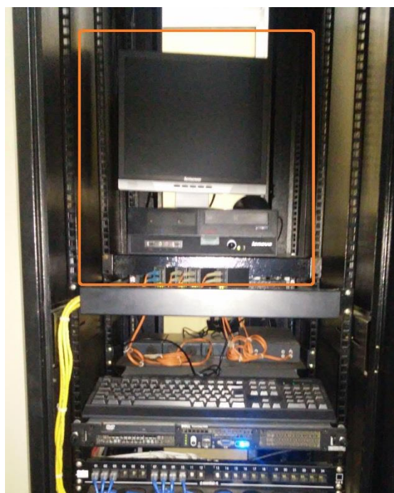
Fig.7 – Computador Instalado no Rack da Rede Corporativa
