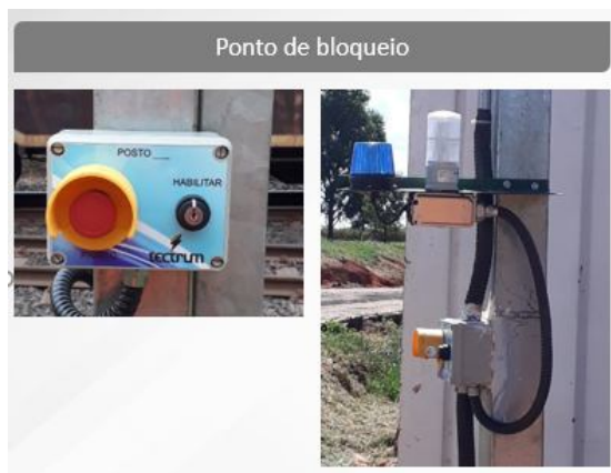
Figura 5 – Ponto de bloqueio, sinalização de campo
