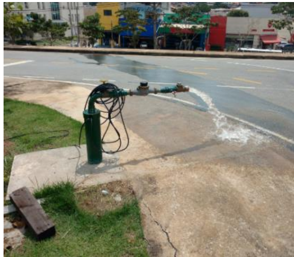
Poço artesiano no Pátio Vila Sônia
