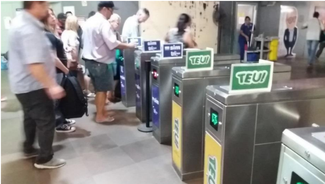
Figura 32 - Vista dos bloqueios com plaquetas instaladas.
