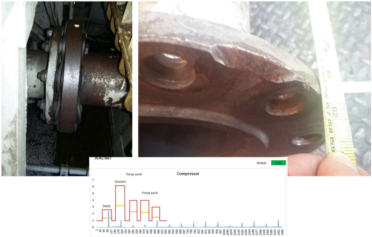
Figura 16 - Problema identificado no compressor da locomotiva 8103
