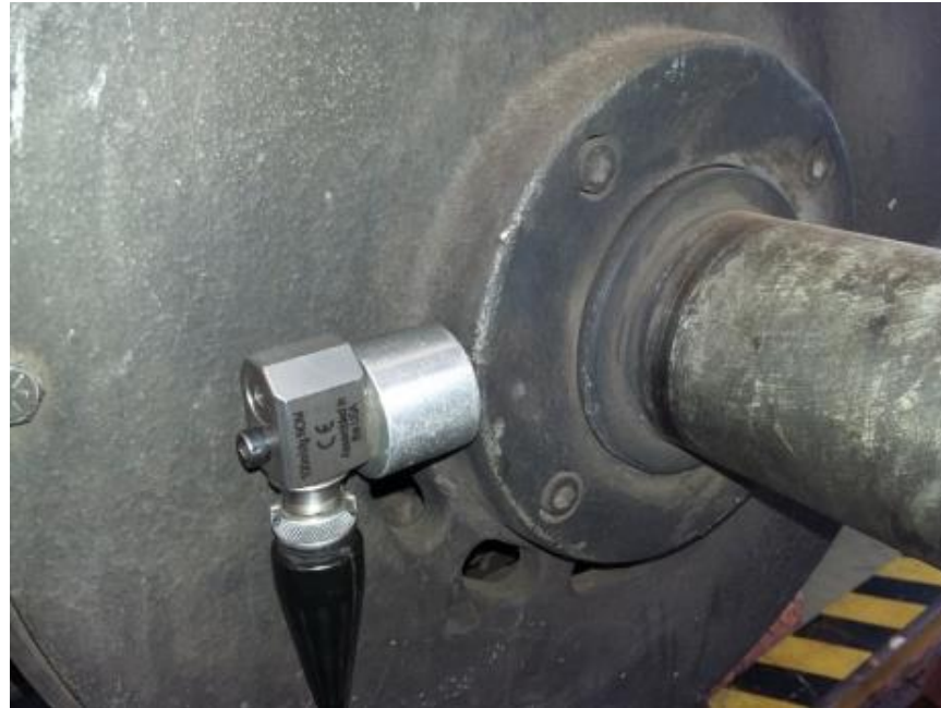
Gerador auxiliar - SD5
