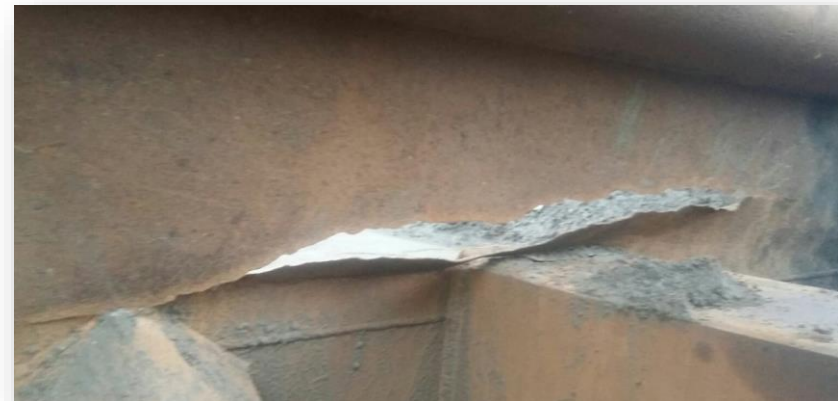
Figura 1: Chapa de vagão trincada
